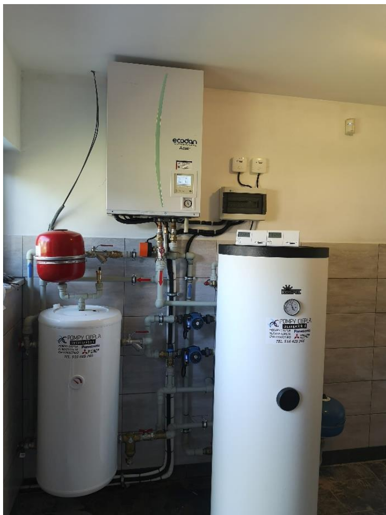
Przykładowe zdjęcie zmodernizowanej kotłowni składającej się z 3 elementów.
